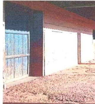
Foto 2: La puerta de madera ya esta muy gastada y en estado de humedad por la lluvia absorbe bastante agua y esta con moho.
