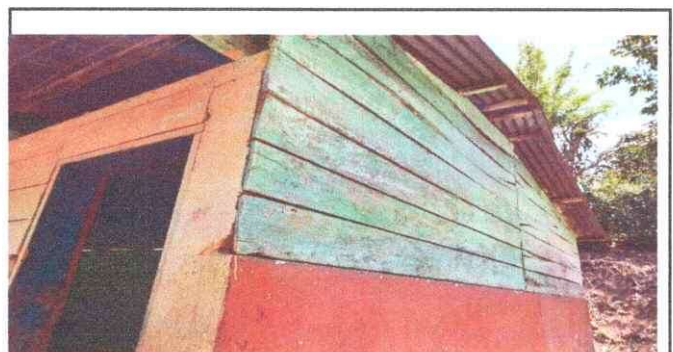
Foto 4: La pared es de 5 hiladas de block y 6 hiladas de tabla por lo tanto es de emergencia la reparación de los mismos debido a la humedad ya se encuentran en estado de moho y humedad avanzada.
