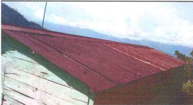
Foto 1: En esta fotografía se observa la presentación y el estado de oxidación de las laminas por lo que se considera un peligro para la salud de los niños porque puede provocar una enfermedad similar a la gripe con síntomas de sabor metálico.
